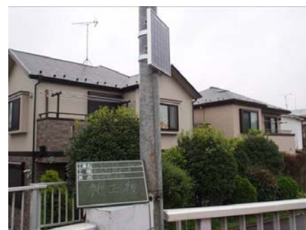
電源は太陽電池のみで稼働
