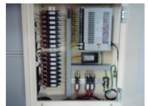
写真-7 充放電コントローラー（改良後）
