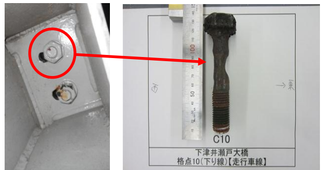
写真-6 セットボルトの断面欠損状況(2)
