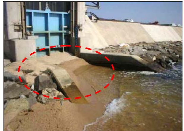
図-2. 中海における排水門の堆砂状況
