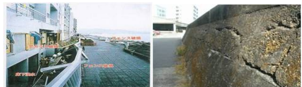
写真-2 台風による被災状況と護岸の老朽化
