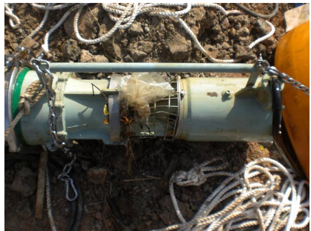
写真4 ポンプへのゴミのつまり状況
