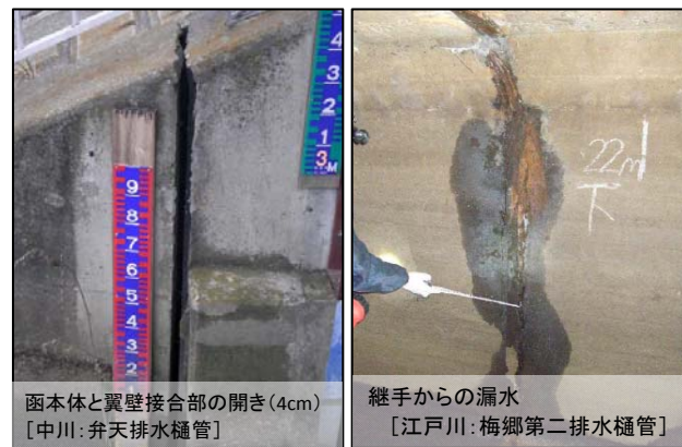
写真-2 現地観察により記録された変状 (その1)
