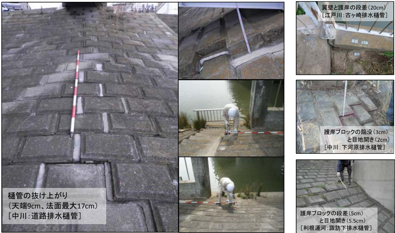
写真-3 現地観察により記録された変状(その2)
