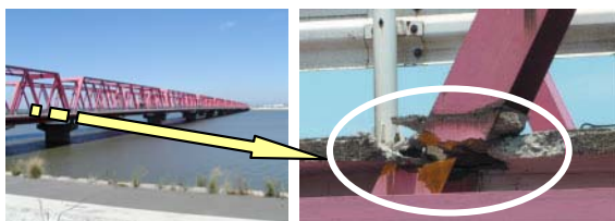
写真-1 国道23号木曾川橋（1963年竣工）トラス材破断
