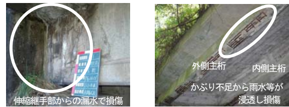
写真-3 コンクリート橋の桁端部、外桁部の損傷状況
