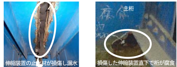
写真-2 鋼橋の桁端部の損傷状況
