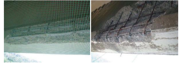
写真-5 P5-A2径間の損傷状況
