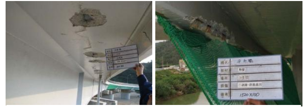
写真-4 A1-P5径間の損傷状況
