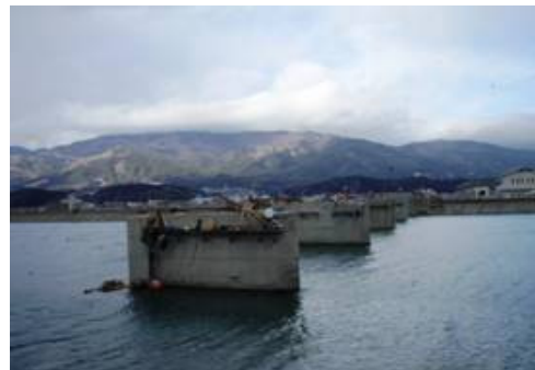
写真-1 上部工が流失した気仙大橋
