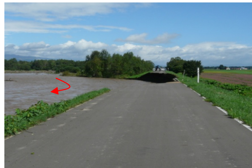
写真-4-1 堤防一部流出箇所
