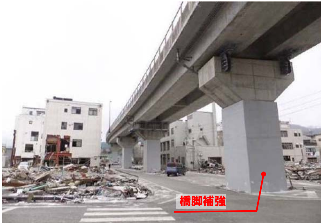
国道45号 (観測震度: 震度6弱 )
