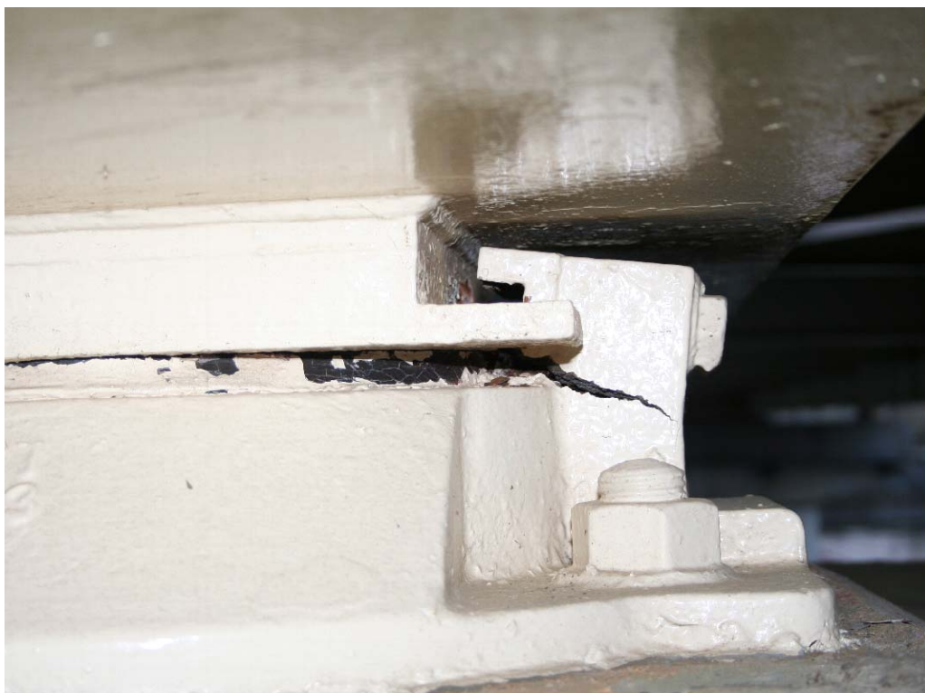
支承部の損傷
