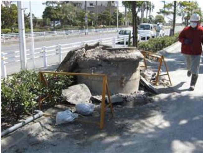
マンホール浮上
