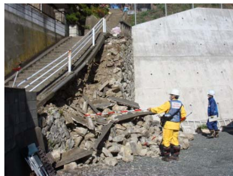
急傾斜地被災状況調査（茨城県）
