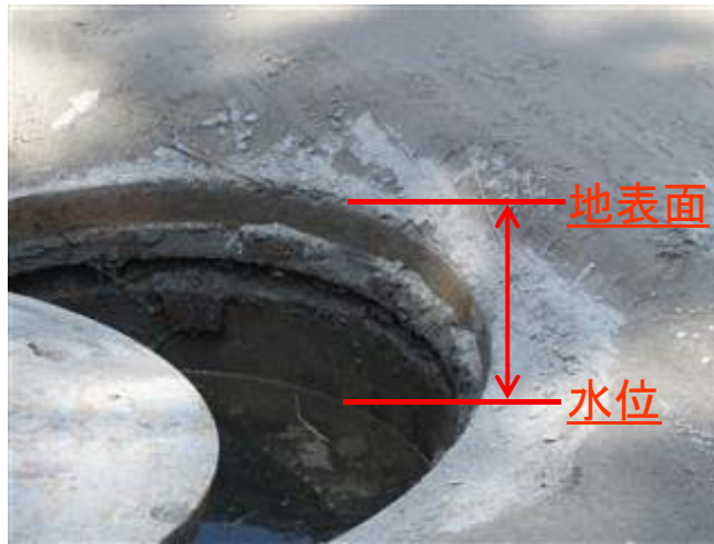
マンホール内満水
