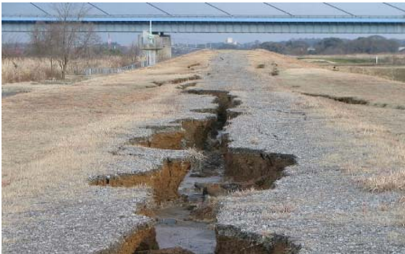
那珂川（茨城県水戸市下大野地先） 液状化による堤防亀裂
