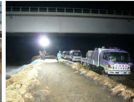
浸水箇所排水（亶理町）
