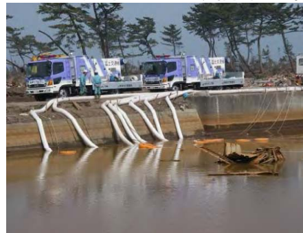
仙台空港周辺排水（仙台市）
