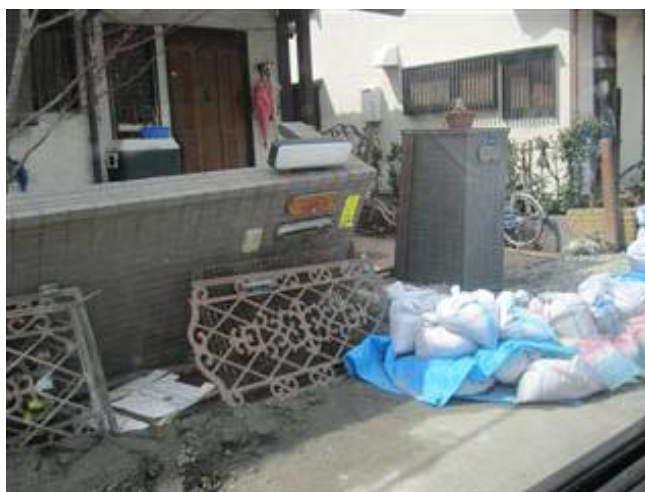
液状化被害(住宅)
