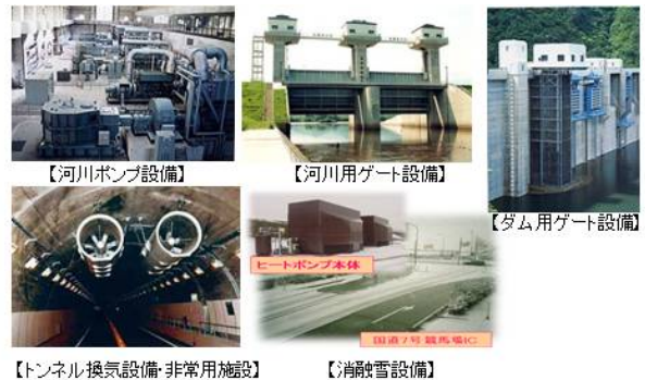
図-1 土木機械設備の例
