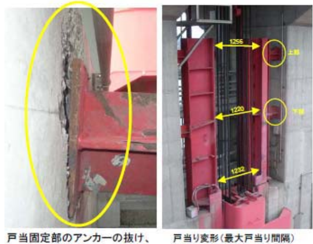
図-23 河川用ゲートの軽構造部戸当り損傷事例
