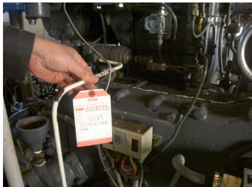
図-22 ポンプ設備の原動機へのエフ付け事例
