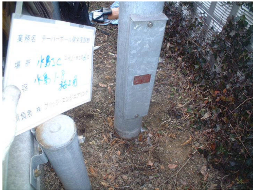
写真-1 埋没した状況
