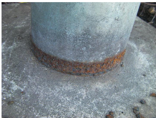
写真-4 腐食状況
