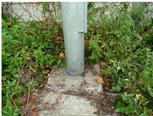
写真-3 草木が取り囲んだ状況
