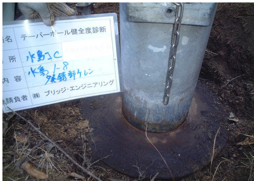
写真-2 腐食状況
