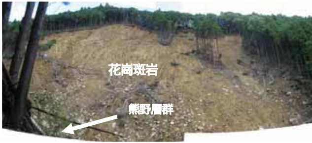
写真-1 金山谷川大規模崩壊地
