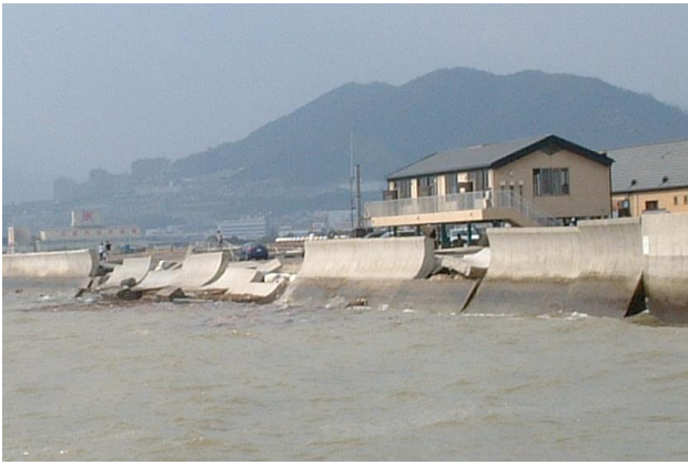
写真-8 現地護岸の被災状況
