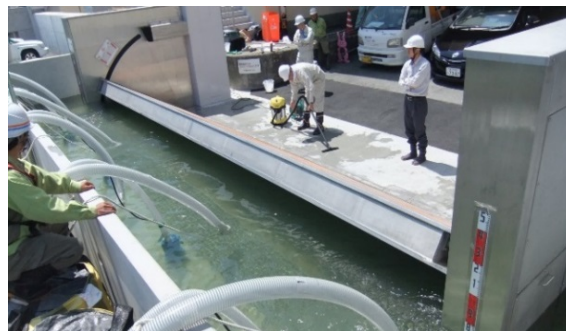
図-16 フラップゲート式陸閘の起立確認試験
