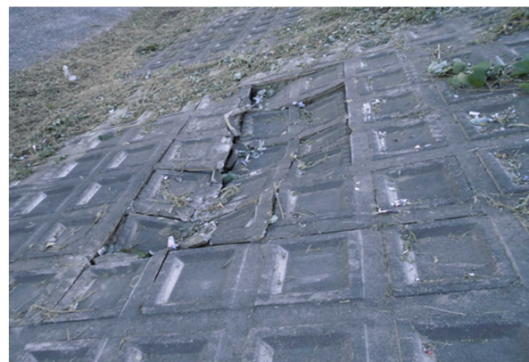
写真-2 護岸裏の空洞化
