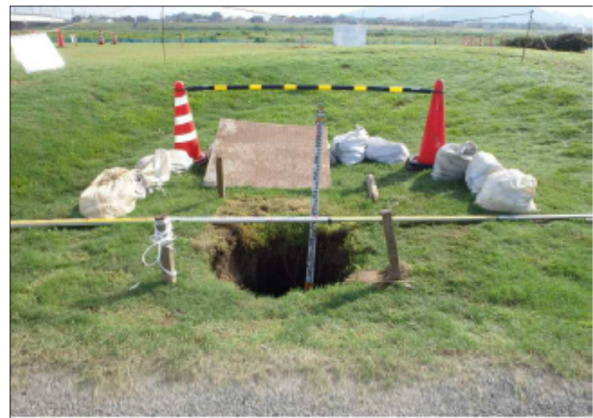
写真-1 高水敷における陥没
