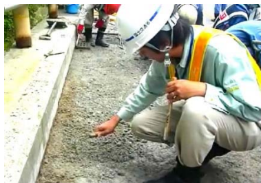
写真-3 緊急開削により床版の土砂化を確認
