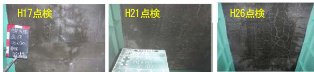
写真-2 橋梁点検による経年変化
