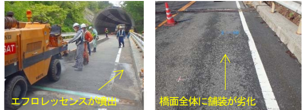
写真-4 応急復旧箇所後の再劣化状況
