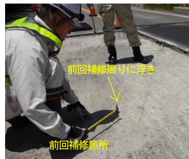
写真-8 ブレーカーはつり周辺箇所の劣化
