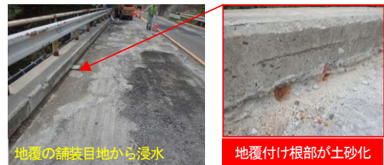
写真-12 舗装目地部のコンクリート部材損傷状況
