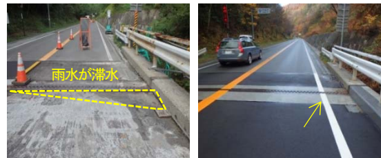
写真-13 排水桁直近の構造改善事例
