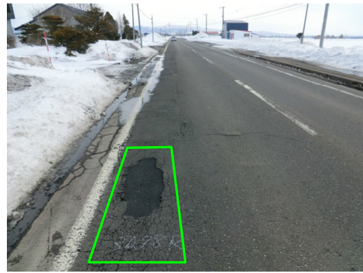
写真-4 写真-3と同一箇所の目視調査時状況
