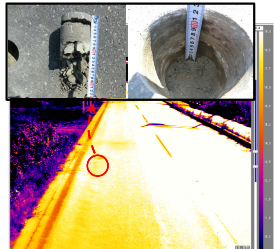
写真-7 ひび割れ部滞水無し暗示信号 判別間違い
