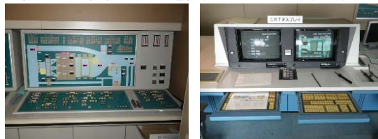
【施設で異なる排水ポンプ操作盤(現在)】
