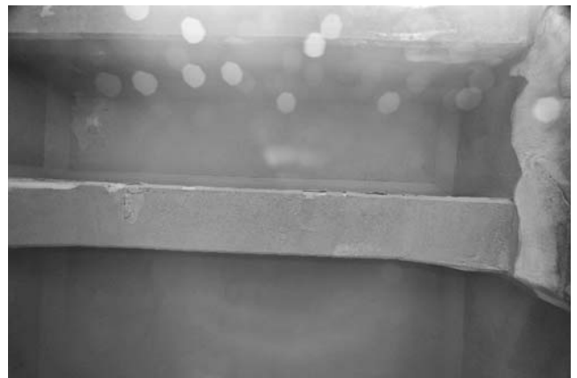
図-5 第1スパン南側の欠損部の写真
