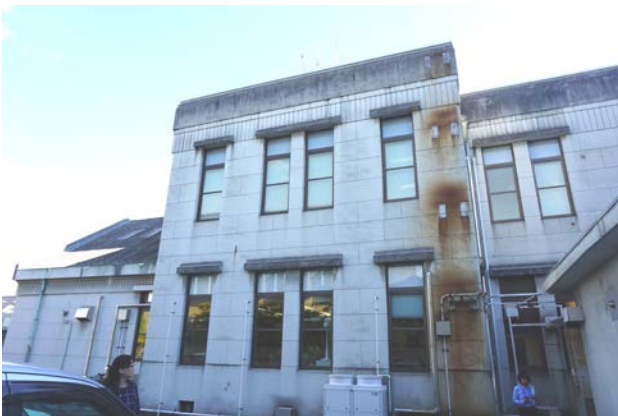
図-3 第1庁舎外壁劣化状況
