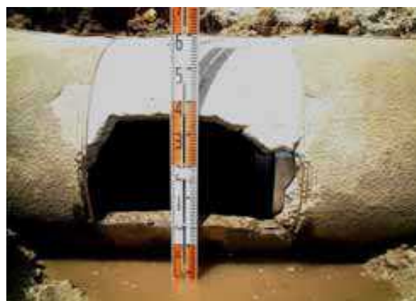
写真-1 PC管の劣化に伴う出水（他地区）
