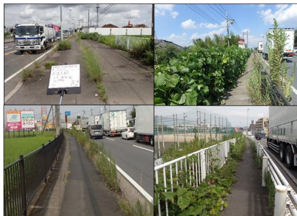
図-4 歩道の雑草繁茂状況
