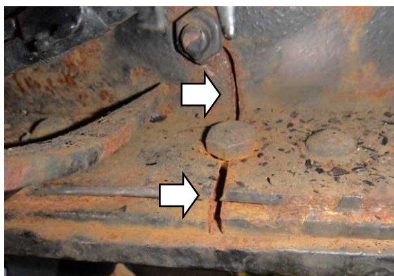
写真-1 大規模故障事例 (フレーム破断)
