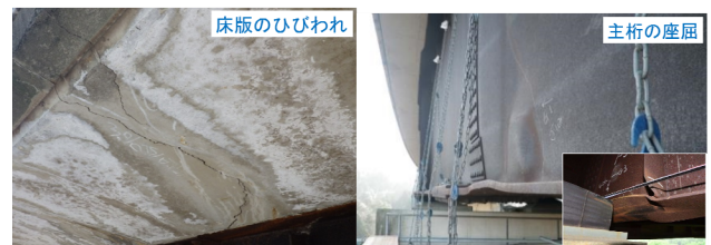
写真-1 大切畑大橋の被災状況
