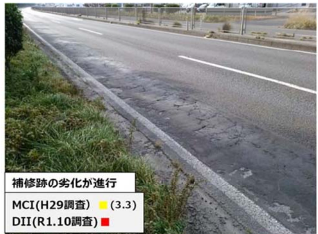
図-6 MCI から進行が進んだ事例
