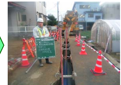
狭小道路における施工工期を短縮すると共に、軟弱地盤対策としても有効
