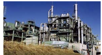
下水汚泥焼却炉
