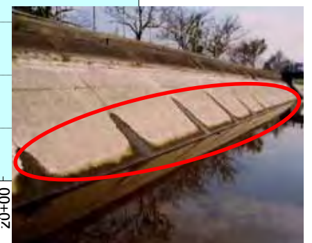
ライニングパネル継目漏水状況
