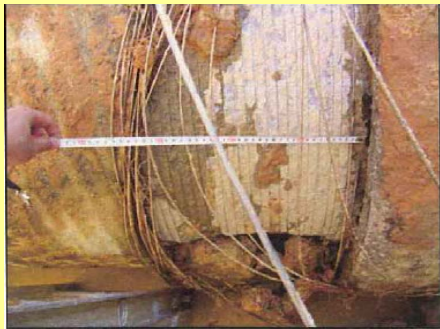
PC管:カバーコートモルタルの欠損とPC鋼線の破断
