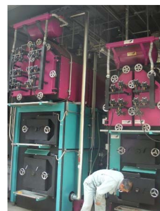
チップボイラー
