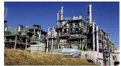
下水汚泥焼却炉
