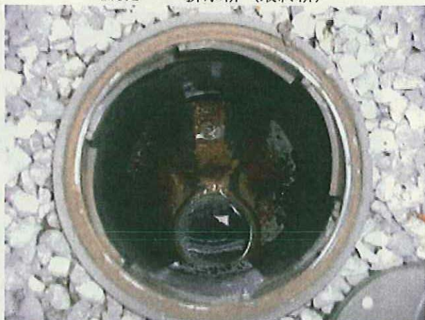
No.2 排水枡（キッチン脇）トラップ付
