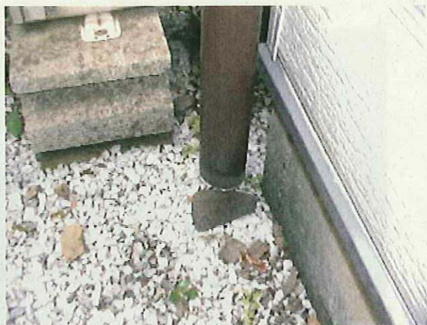
No.7 北西角縦樋 端末の開放状態
