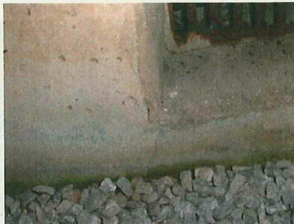
No.10 西面基礎 床下換気口脇の軽度なひび割れ
