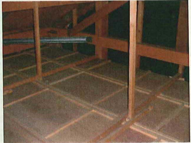
No.16 屋根裏 天井裏の断熱材が敷かれていません。
