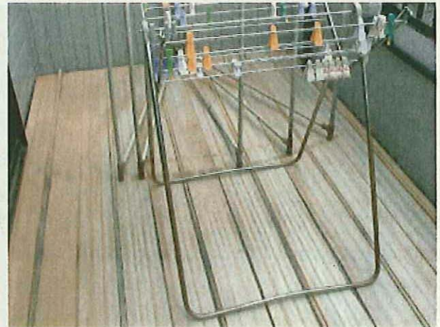
No.23 バルコニー 床目地材の一部変形問題ありません。
