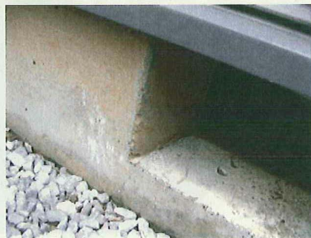
No.9 東面基礎 換気口脇の軽度なひび割れ
