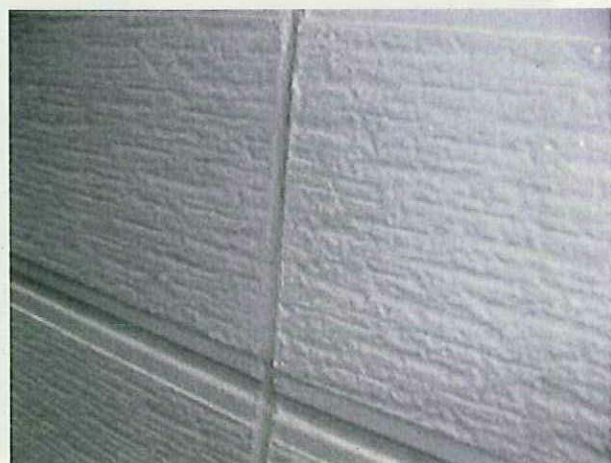
No.8 北面外壁 目地シールの軽度な界面剥離
