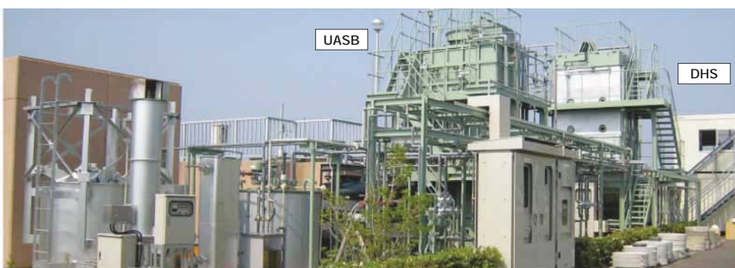
写真1 UASB-DHSシステムの実証試験プラント(霧島市国分準人クリーンセンター内に設置)
