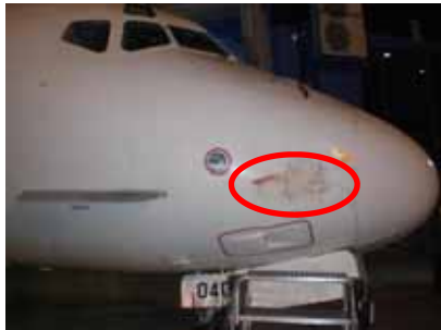
(写真左上) 損傷した外板
