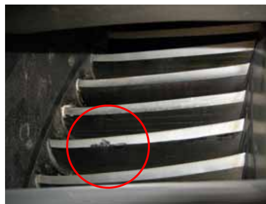
(写真上) アウトレット・ガイド・ベンの損傷
