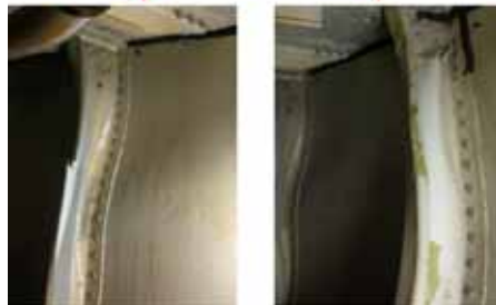
(写真右上及び右下2枚) 損傷したフレーム
