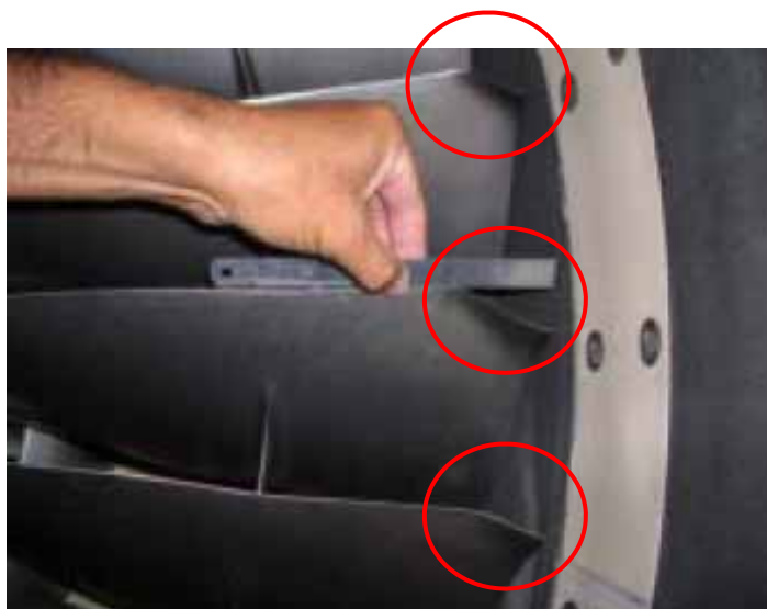
(写真左) 損傷したファンブレード
