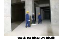
雨水調整池の整備 (名古屋市 平田第二雨水調整池)
