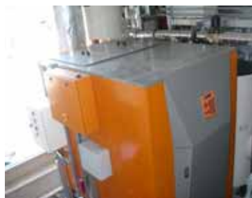
座光寺保育園ペレットボイラー
