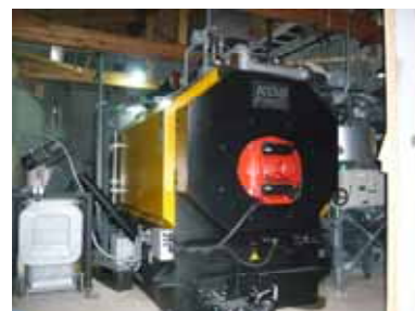
かぐらの湯ペレットボイラー
