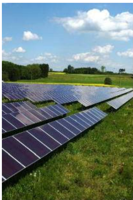
太陽光パネル
