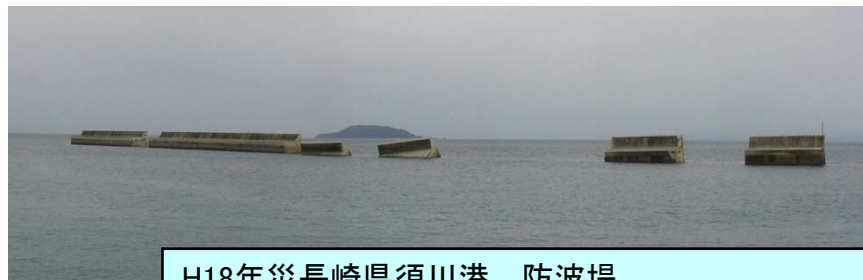
H18年災長崎県須川港 防波堤 ※台風13号による被災
