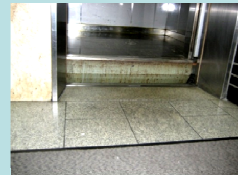
エレベーター着床時の段差
