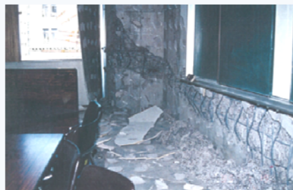
内部の被災状況
