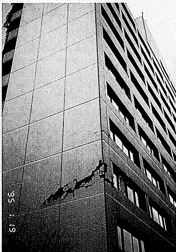
〔柱が破断するなど構造体が損傷し、機能の復旧に時間を要した〕
