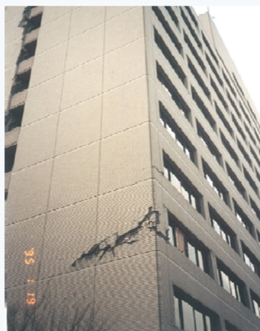
柱が破断する等構造体が損傷し、機能の復旧に時間を要した
