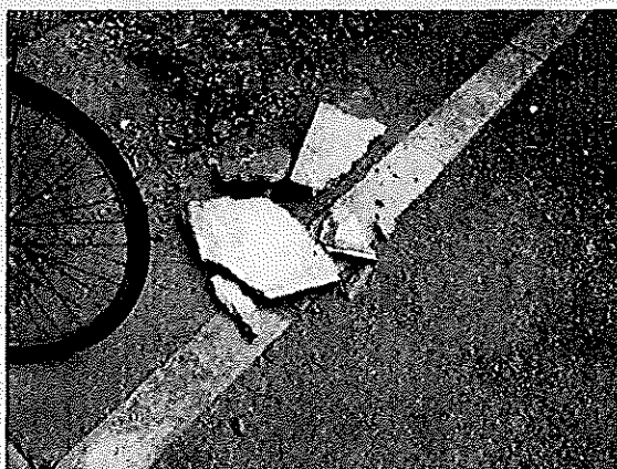
外壁モルタルの落下
