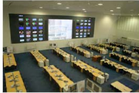
オペレーションルーム（2Fから）
