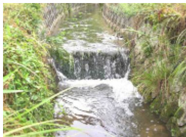
現況は段差があり、ネットワークが分断
