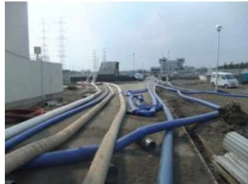
水処理施設へ送水 (白いパイプ3条が直轄ポンプによるもの)
