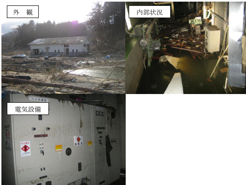
図3-11 山田町前須賀中継ポンプ場の被害状況（3月22日）
