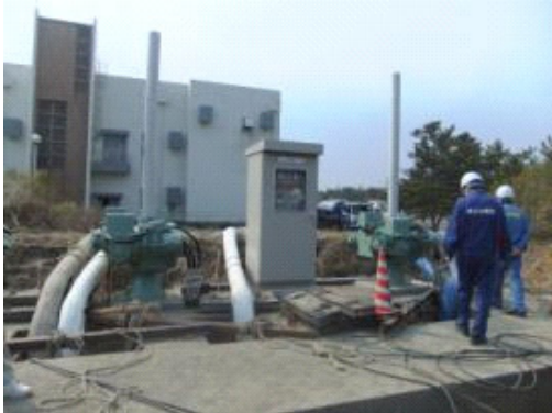
流入ゲート前において仮ポンプで排水 を行っている様子
