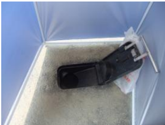
マンホールトイレ（和式）
