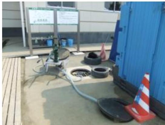
手前の防火水槽から水をくみ上げ、 フラッシュさせる仕組み。
