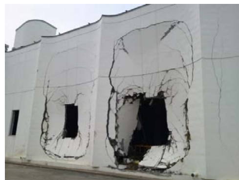
津波により被災した下水処理場 (仙台市 南蒲生浄化センター)
