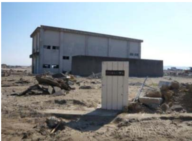
ポンプ施設の損傷 (亙理町 荒浜雨水ポンプ場)
