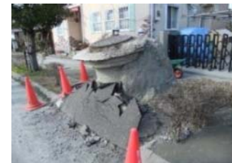
液状化による隆起したマンホール(千葉県浦安市)
