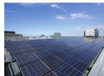
丸の内パークビルの屋上に設置した太陽光パネル
