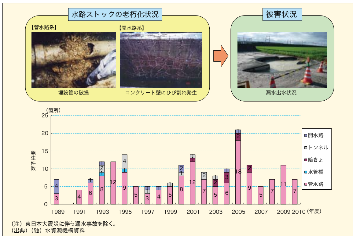
図1-3-7: (独) 水資源機構の施設における漏水事故
