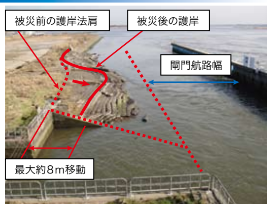
利根川河口堰 こうげん 閘門下流部の護岸崩落
