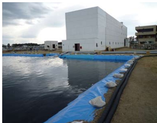
仮設沈殿池（宮城県南浄化センター） （出典）国土交通省下水道部資料
