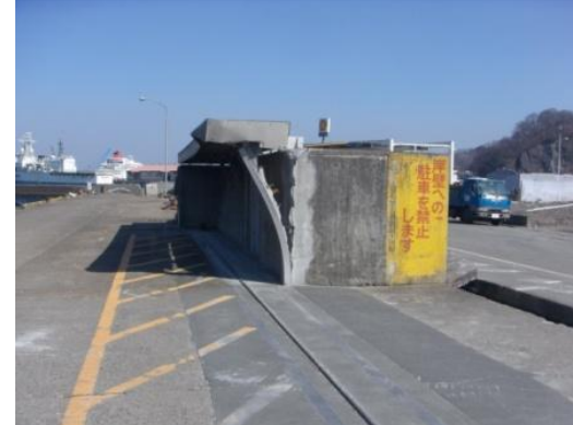
陸閘が海側に破損・流出 (写真: 釜石港海岸須賀地区)
