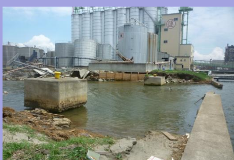
地盤沈下や護岸損壊による浸水の被害が甚大なサイロ(石巻港)
